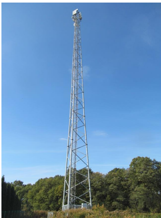
Zał. nr 1: Widok ogólny instalacji radiokomunikacyjnej.
